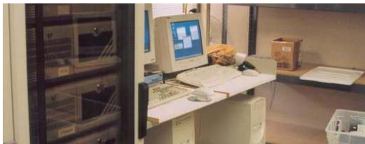
Salas de ordenadores/ servidores
